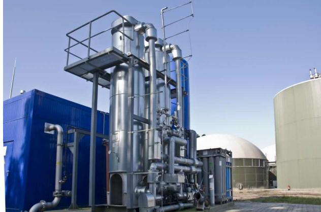
Abb. 7: Methanisierungsanlage der AUDI AG in Werlte
